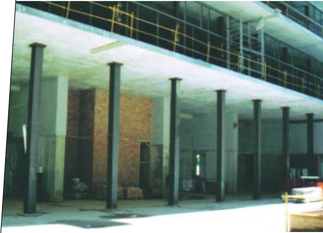
3. Puntals HEB 300 cada 3,6 m sota els tirants interiors de sectors II i III. 4. Interior de sector I apuntalat. 5. Forjats apuntalats exteriorment cada 3,6 m durant les fases constructives.
