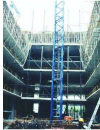
3. Apeos HEB 300 cada 3,6 m bajo los tirantes interiores de sectores II y III. 4. Interior de sector I apeado. 5. Forjados apeados exteriormente cada 3,6 m durante las fases constructivas.
