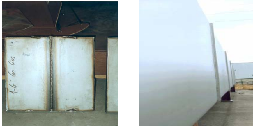
Figura 9: Oxidación por soldadura de la capa de pasivación y paneles ya limpios.
