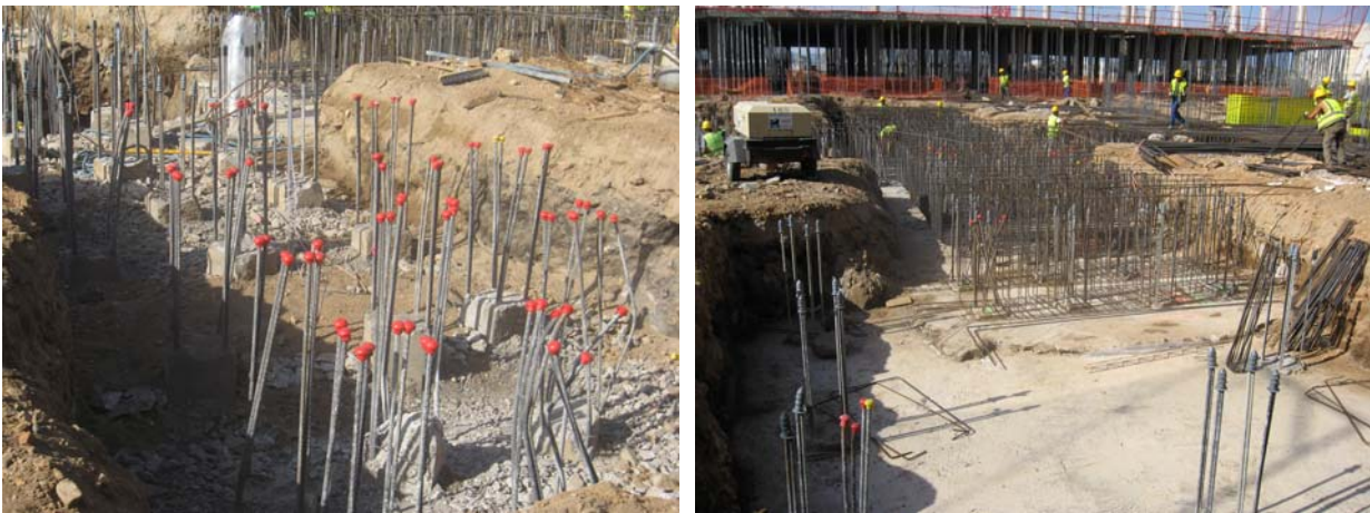
Figs. 8a y 8b: Vista de pilotes prefabricados hincados y encepados de la Torre durante su ejecución
