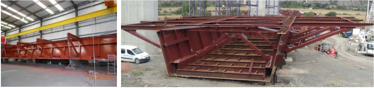
Figuras 11a y 11b. Imágenes de la fabricación de medio cajón en taller y del ensamblaje de una dovela en obra
