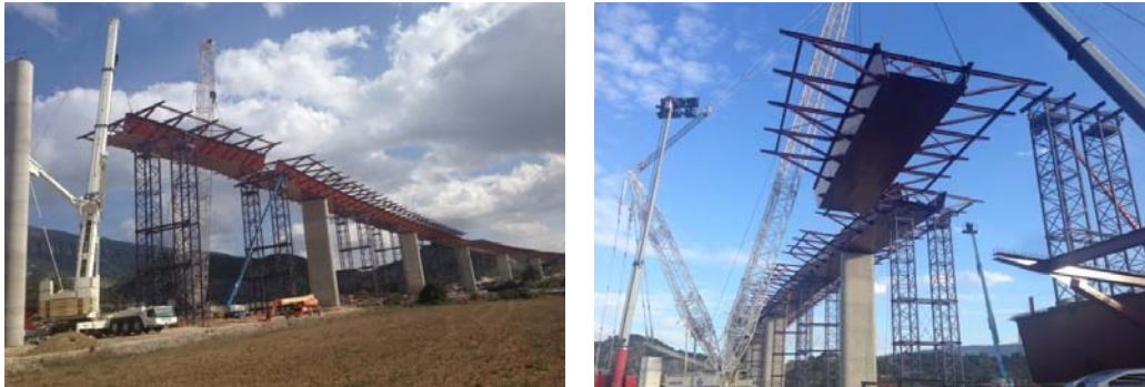
Figuras 13a y 13b. Torres de apeo provisionales e izado de dovelas metálicas
