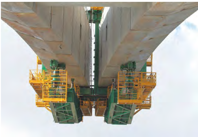
Figura 12. Vista trasera desde el estribo de los carros una vez realizada la maniobra de unión de carros.
