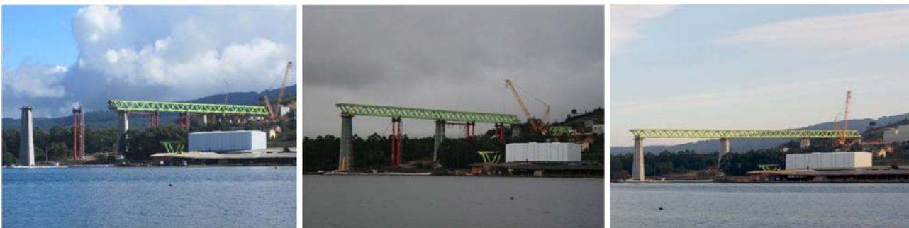
Figuras 6a, 6b y 6c. Segunda fase de lanzamiento, tramo de 240 m ya lanzado entre P-3 y P-4 y ejecución de fase 3 (dic. 2013)
