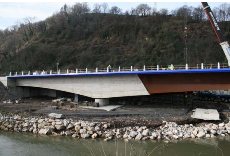
Fig. 4: Vista de uno de los vanos laterales de hormigón con 27.5 m de luz.
