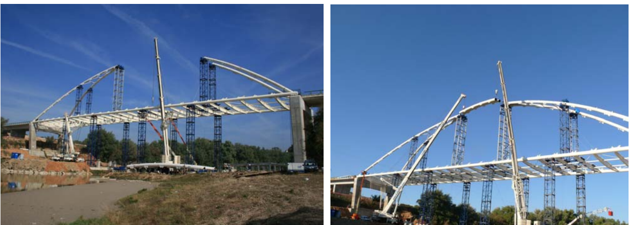
Figs. 10a y 10b: Vista durante las operaciones de izado de los arcos, y fase de cierre en clave de los arcos
