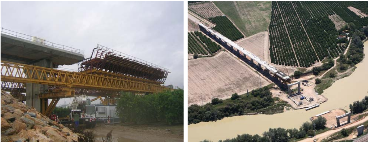
Fig. 2a y 2b: Vistas durante la ejecución del viaducto de acceso sur con autocimbra
