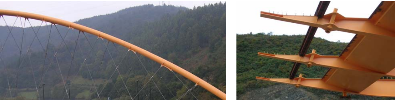
Figs. 11a y 11b Detalles de anclajes superiores e inferiores de las péndolas
