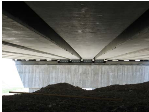
Fig. 16: Vista de los 4 apoyos centrales unidireccionales tipo POT
