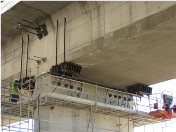
Figura 18. Detalle de diafragma de pila reforzado mediante barras de pretensado.
