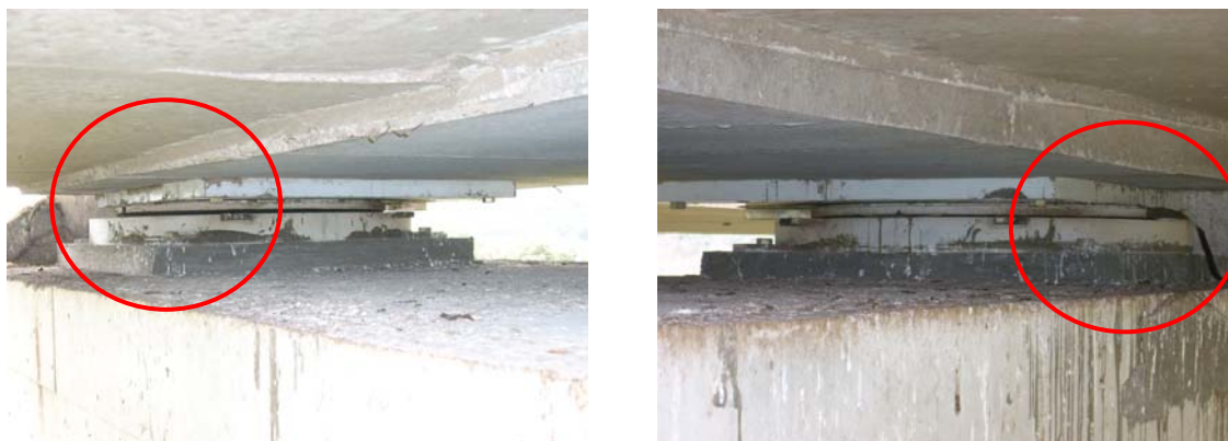
Figuras 8 y 9. Aparatos de apoyo de pila 1, en donde se observa el agotamiento de las carreras de las bandejas deslizantes. En la imagen derecha se puede observar el teflón de la guía roto y fuera de su posición original.
