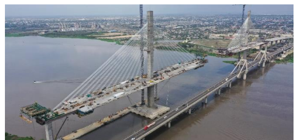
Figura 4. Vista de los carros de avance por voladizos sucesivos y los carros de alas 3 dovelas por detrás
